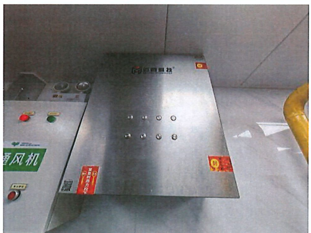
厨房设备灭火装置
