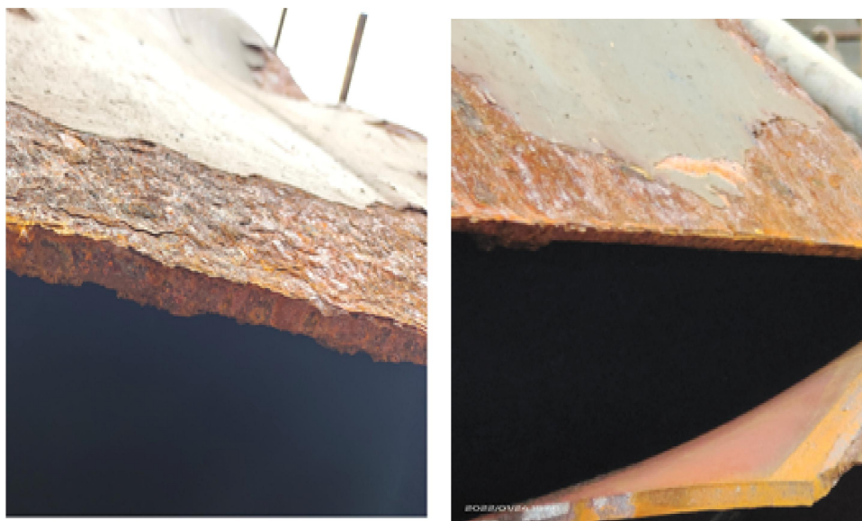
图 5：延伸臂连接焊缝附近锈蚀
