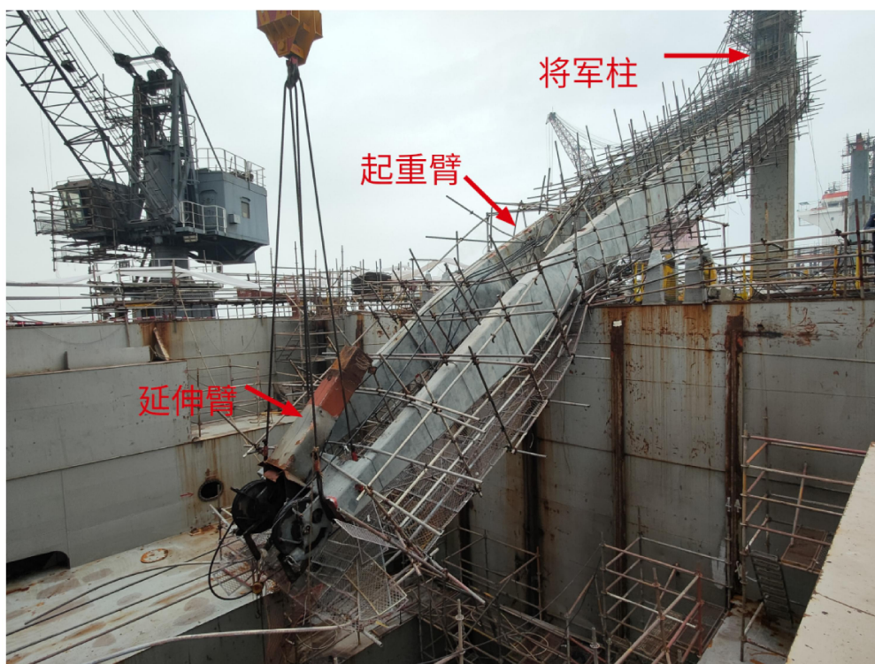
图 1：1#克令吊起重臂塌落状态
