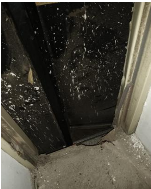
图 6 轿门门扇变形脱轨
