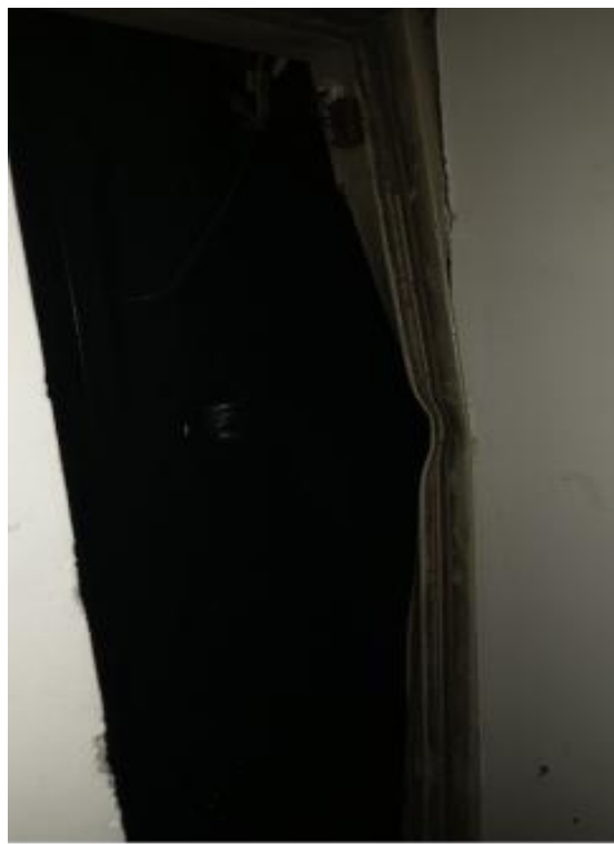
图 7 安全门门框变形
