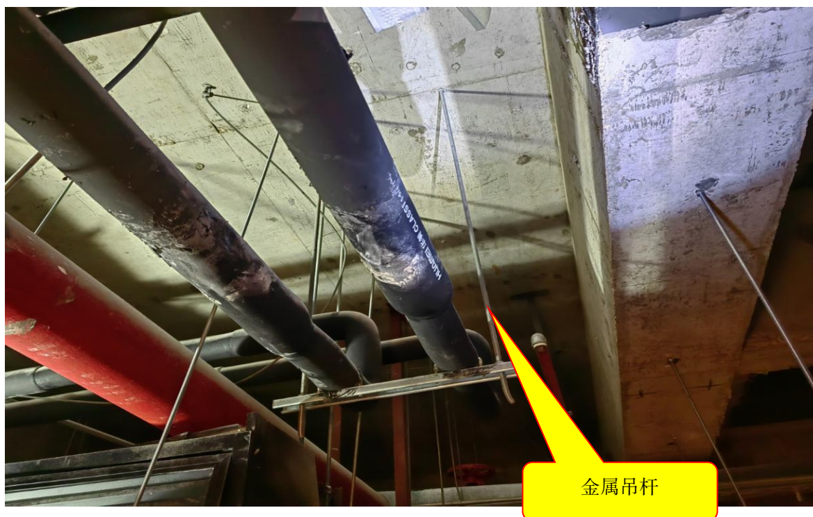
图 6 空调冷凝管吊杆状况
