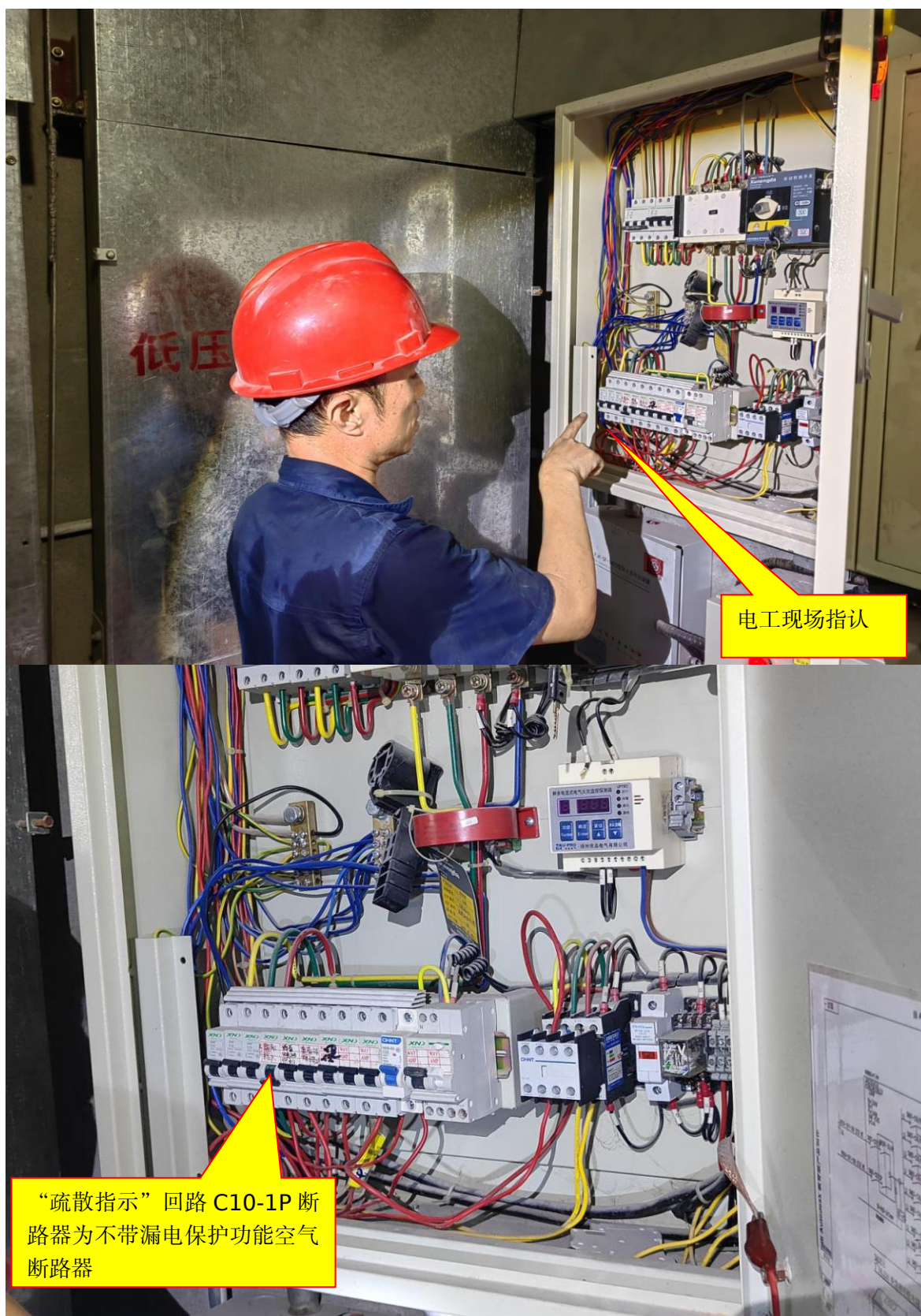
图9 配电箱内“疏散指示”回路断路器状态 经量测“疏散指示”回路对地交流电压为 234V（图 10）。
