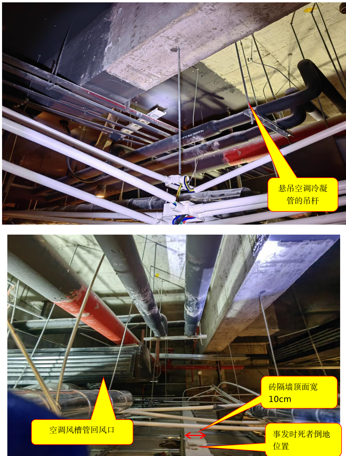
图 5 1#房间吊顶处情况
