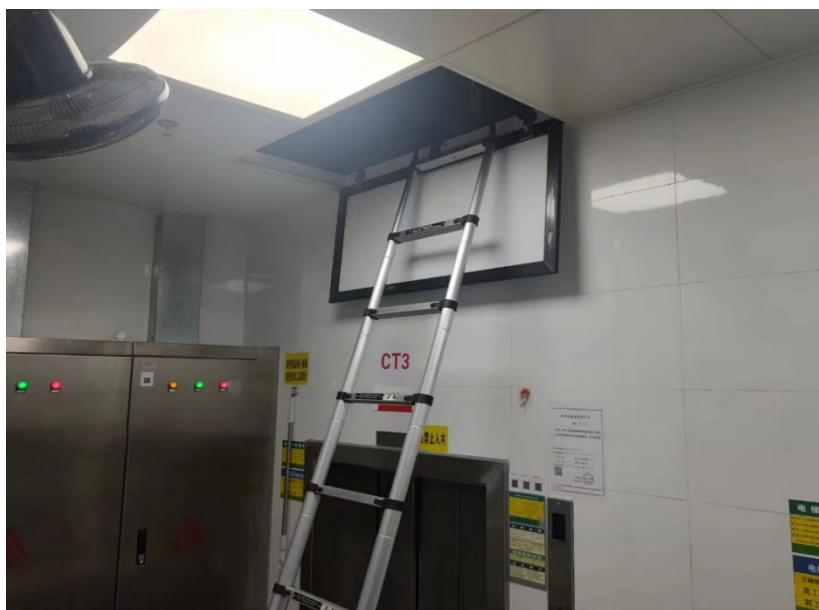
图 3 通过爬梯进入机房空间
