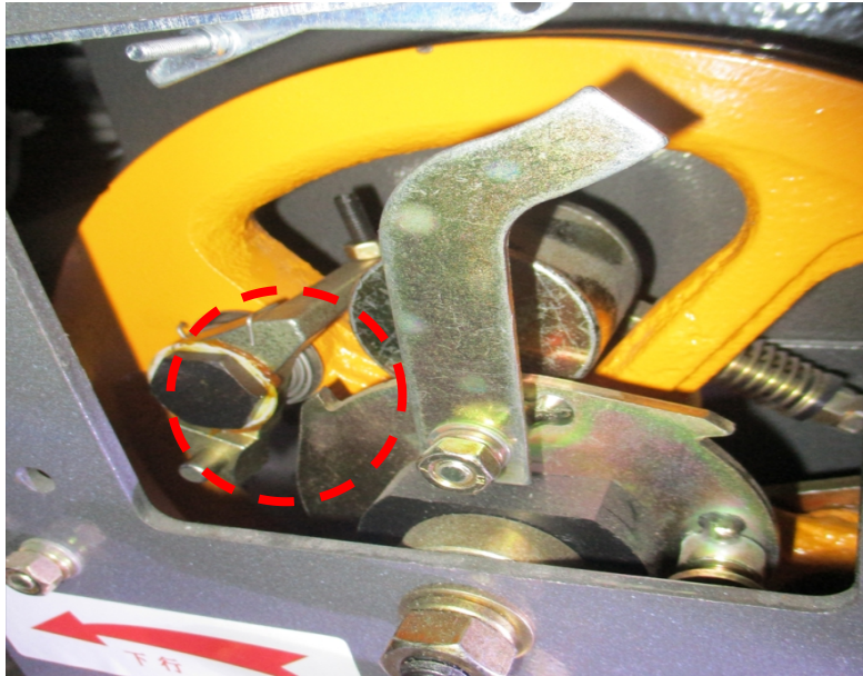
图 19 轿厢限速器机械装置未做出限速动作
