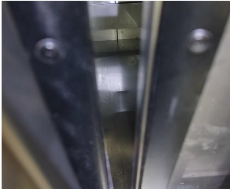
图9 现场查看轿厢底板已变形
