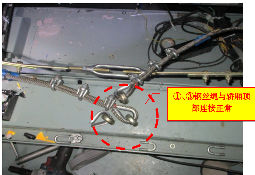
图 13 1#、3#钢丝绳与轿厢顶部连接正常
