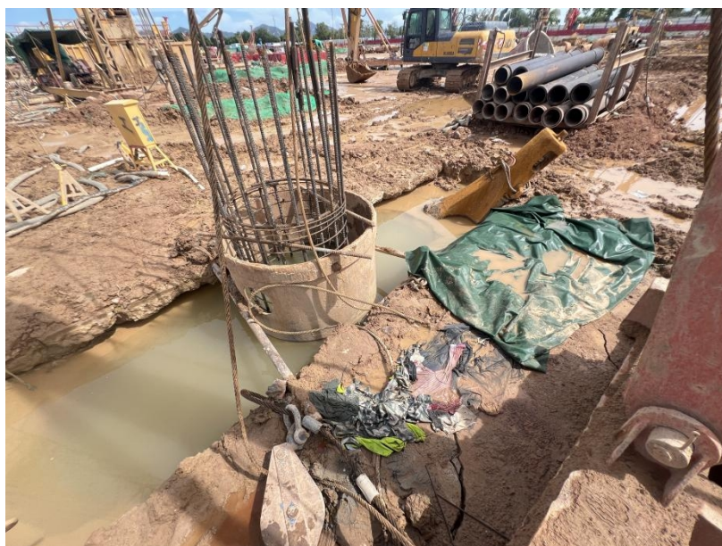
图3 涉事桩孔地面情形
