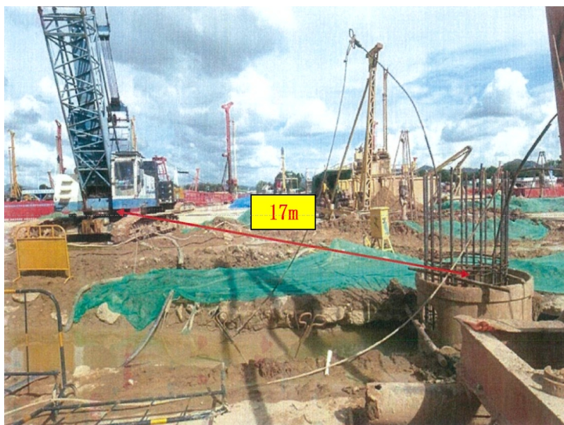
图2 事发现场涉事履带吊及钢筋笼状态
