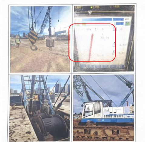
图 16 事发当日涉事履带吊检查记录
