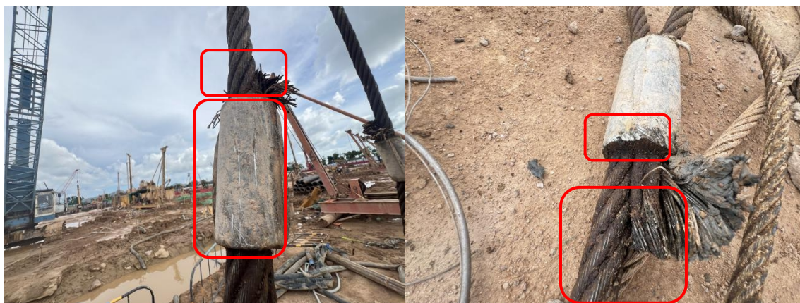
图 9 涉事履带吊主副吊钩吊索划痕位置
