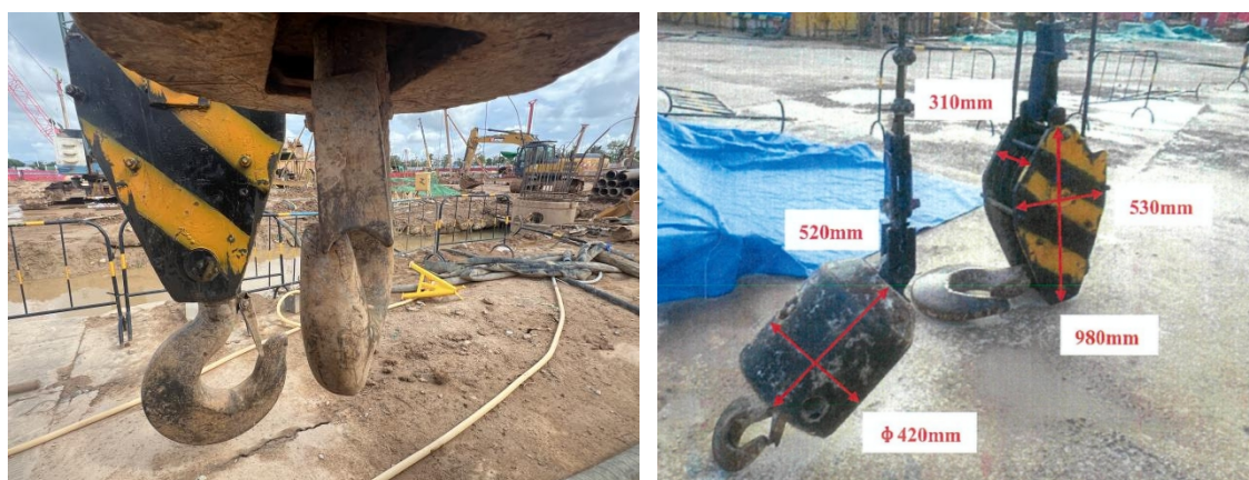
图 6 涉事履带吊主副吊钩及闭锁装置
