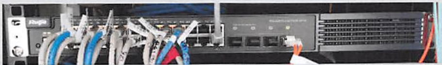
POE 供电设备
