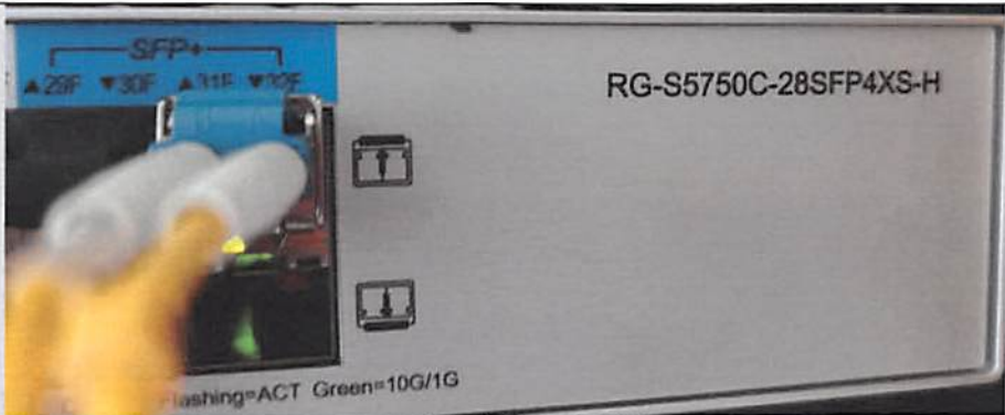
汇集数据交换设备型号
