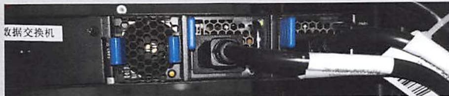
汇聚交换机电源、风扇
