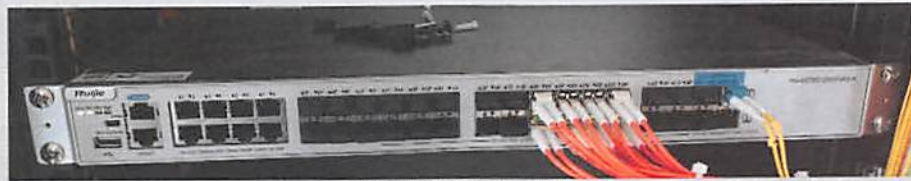
汇集数据交换设备
